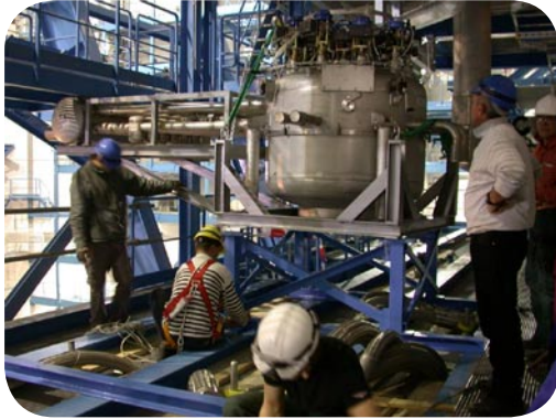
Figure 2: Installation boîte à vanne azote du Barrel (caverne ATLAS, CERN).
