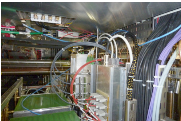
Fig. 2: Le point de connexion PP2 (Patch Panel 2).
