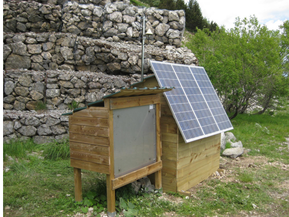
Fig. 6: Station centrale du réseau NOY installée dans le parc régional de Chartreuse.
