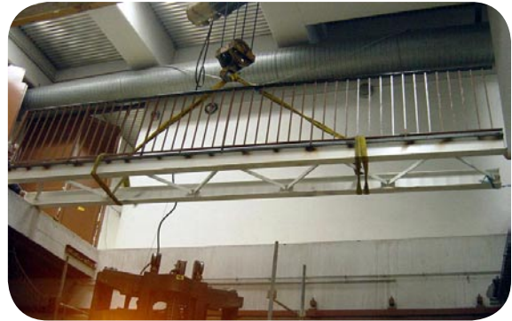
Figure 4: Élargissement d'un passage pour le transport des coupleurs. RF de SPIRAL 2.
