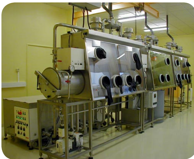
Figure 15: Ensemble des 3 boîtes à gants.
