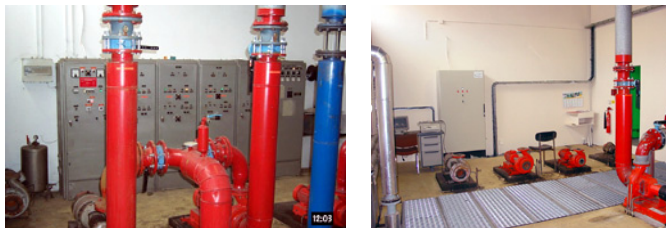
Figures 5 : a) L'ancienne armoire de commande ; b) la nouvelle.
