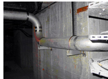
Figure 4 : Les conduites d'eau.
