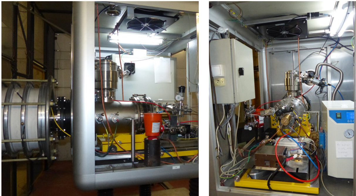
Fig. 1: nouvelle source ECR dans la plateforme haute tension de GENEP12.
